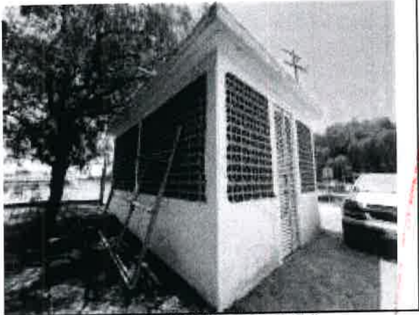
CUARTO DE GAS NATURAL (T-17.1)
